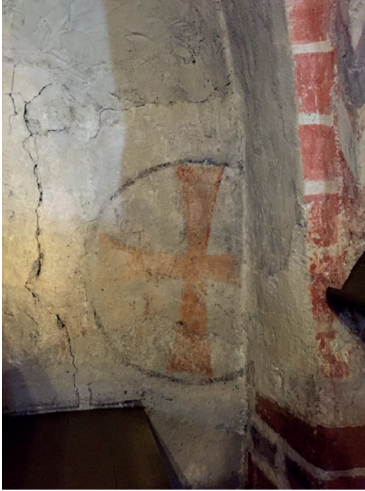
Kuva 13. Holvien pilasterien lisääminen kirkkosaliin näkyy myös seinien maalauksissa. Parvella kirkon seinään maalattu vihkiristi on jäänyt osittain pilasterin taakse. Kuva: Marko Huttunen.
