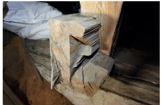
▲▲ Kuva 10. Alapaarteiden katkaisemisen yhteydessä kattotuoleja vahvistettiin vastakkaiset konttipuut yhdistävällä vetoparrulla. Liitosten pitkiksi jätetyt tammitapit poikkevat puulajiltaan kattorakenteen muusta puutavarasta. Kuva: Mia Puranen.
