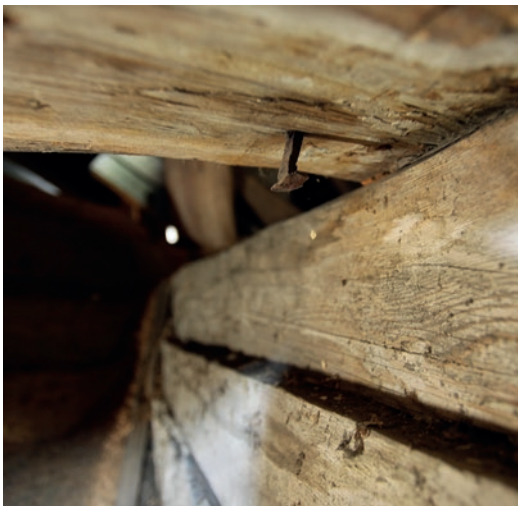
Kuva 7. Laipiolaudojen kiinnitysnauloja on jäänyt alapaarteiden alapintaan. Kuva: Panu Savolainen.
